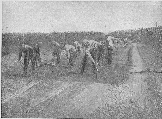
Прокладка образцовой дороги между г. Истра и Москвой. На снимке — бригада г. Царева выравнивает полотно шоссе.
